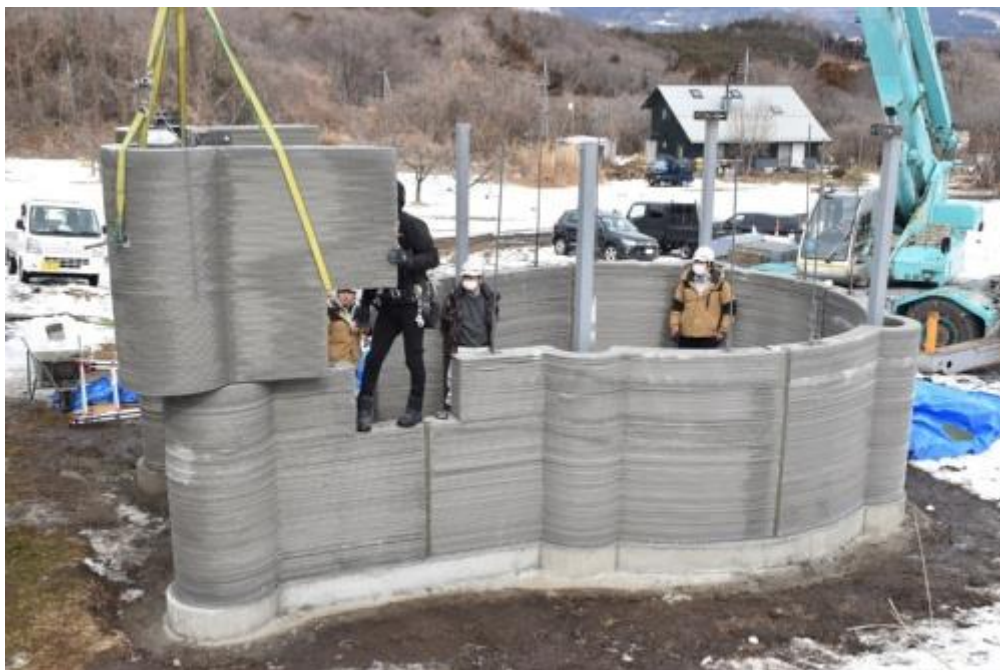
建設 3D プリンターで印刷した部材を現場で組み立てる様子。2022 年 2 月 12 日撮影
